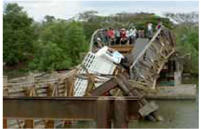
図-1 過積載による仮設橋の崩壊 2)
