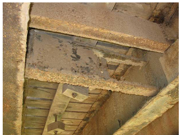
図-4 腐食により消失した横桁 (ロシア基準鋼橋)
