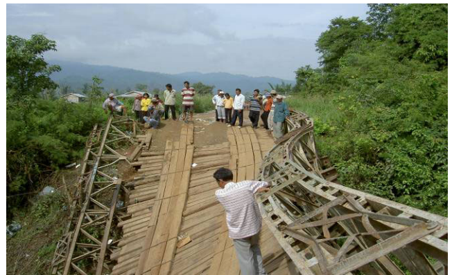
図-2 仮設橋の崩壊事例 (MPWT 提供)
