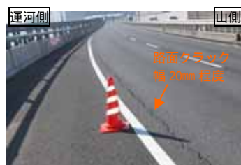
写真-1 路面クラック
