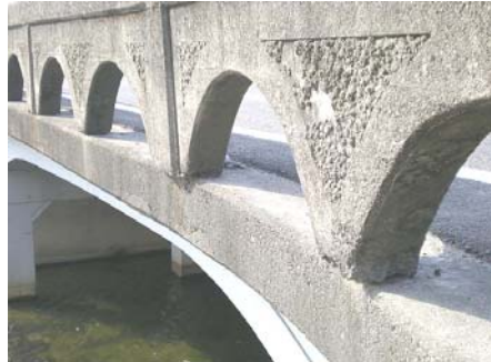
写真-6 既設高欄基部の損傷
