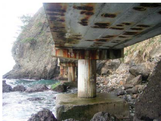
写真 1 PC 桁の劣化状況
