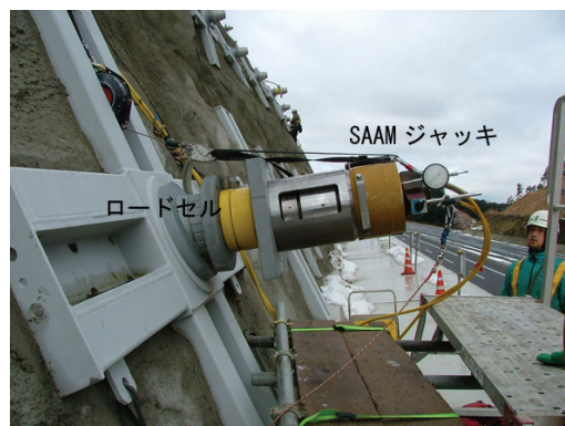
図－1 A地点のアンカー状況
