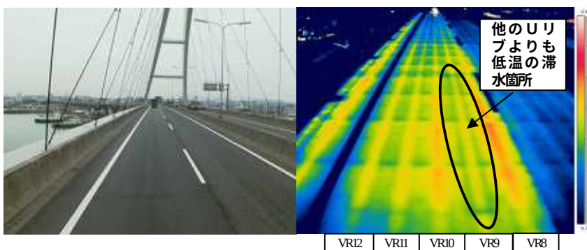
図6. 舗装面上からの撮像による可視画像（左）及び熱赤外線画像（右） ※VR9単体リブの舗装面からの滞水推定箇所（右図）は滞水実験箇所
