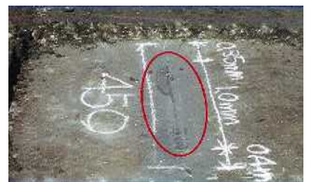
図1. 鋼床版貫通亀裂
