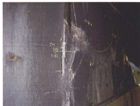
写真-1 覆工破壊状況
