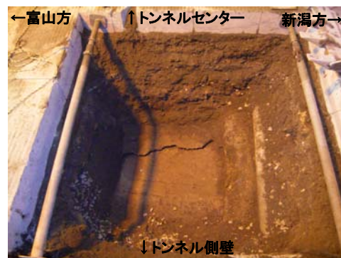
写真-2 インバート破壊状況
