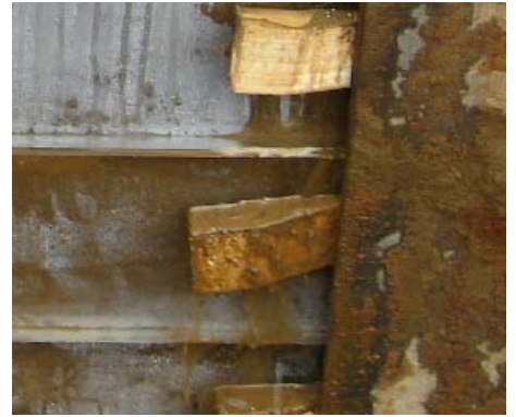
土砂流出状況
