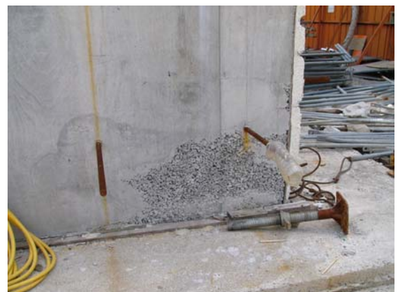
写真-2 ジャンカの発生状況
