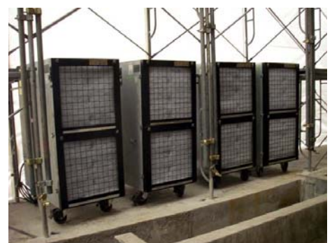
写真-2 換気集塵機(屋内型)
