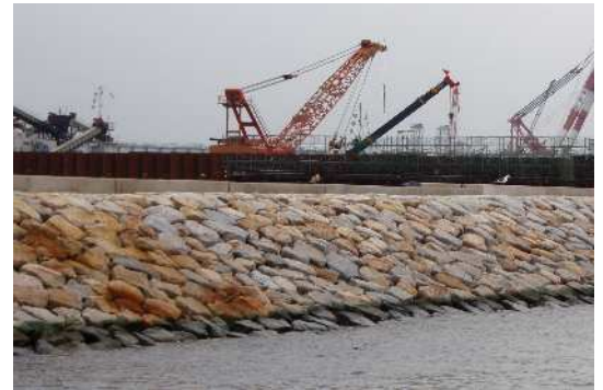
写真-2 現地の状況 (被覆石)
