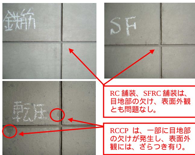
写真-1 供用 6 ヶ月後の舗装表面の写真
