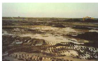
写真-1 砂盛土表層（雨天後）
