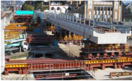
(写真-2 横取り設備全景)
