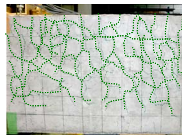
図-6 再生 RC 部材に発生した乾燥収縮ひび割れ
