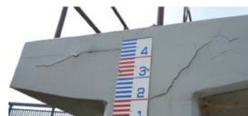
写真-1 調査再劣化構造物 (A樋門)
