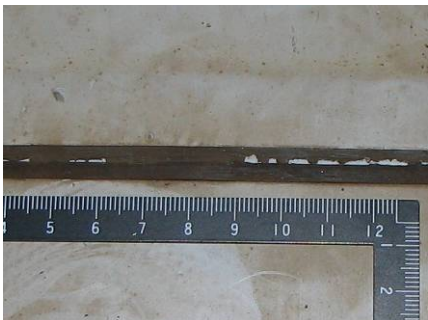
写真-5 シーリング材の剥がれ
