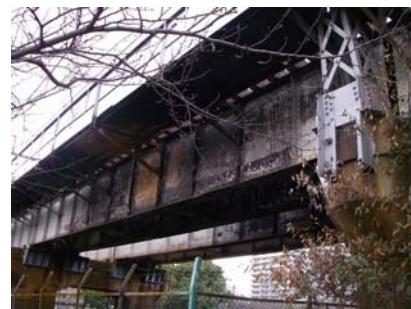
図.1 被災箇所の外観
