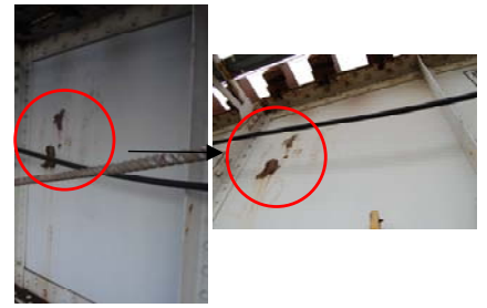
外回り線 3 連目-⑩ 右側腹板外側
