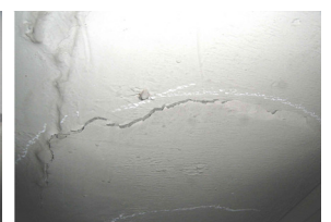
写真-3 ひび割れの段差
