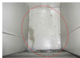
写真-1 損傷部①
