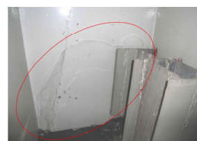
写真-2 損傷部⑤
