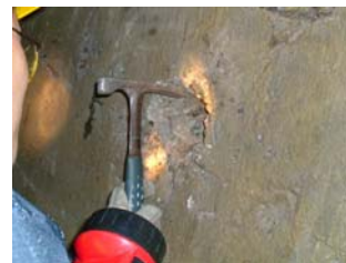
写真1 表層コンクリートの軟化
