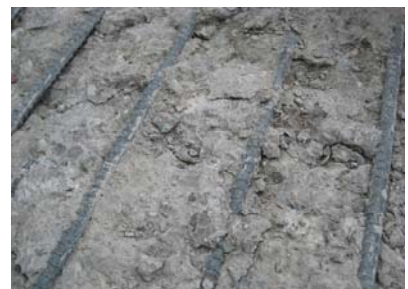
写真4 40m 付近のはつり底面状態
