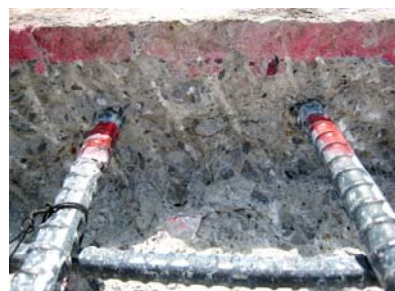
写真6 40m 付近外枠面(エリアB)
