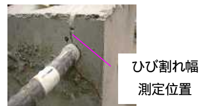
図 3 ひび割れ幅測定位置
