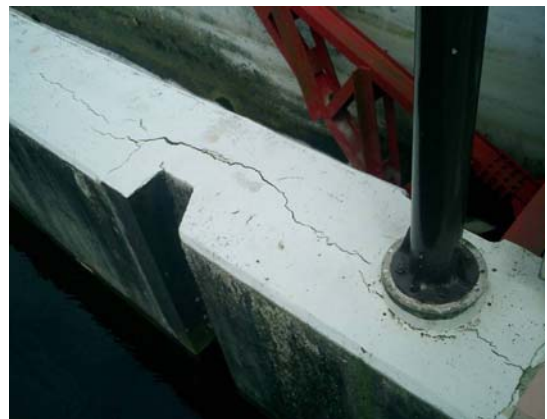
写真-2 実構造物のひび割れ状況
