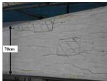
写真1 劣化構造物外観
