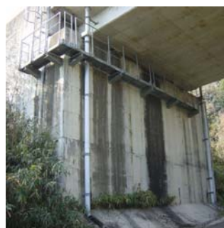
写真-1 橋台の漏水跡状況
