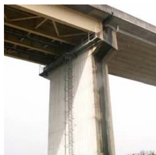
写真-2 橋脚の漏水跡状況
