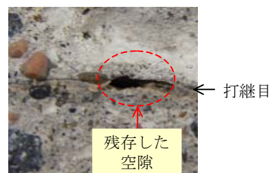
図4 打継目に残存した空隙(エポキシ樹脂を塗布)
