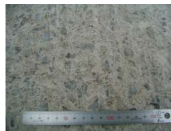
写真-6 床版面④
