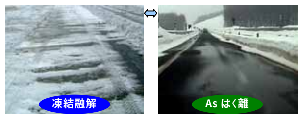
写真-2 高機能舗装の損傷状況
