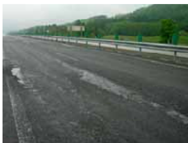
写真-1 高機能舗装の損傷状況
