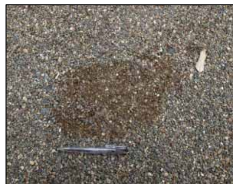
写真-1 骨材飛散状況
