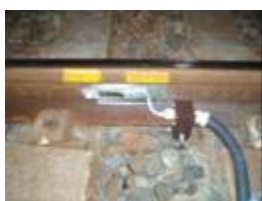
写真1：LR 状態監視装置
