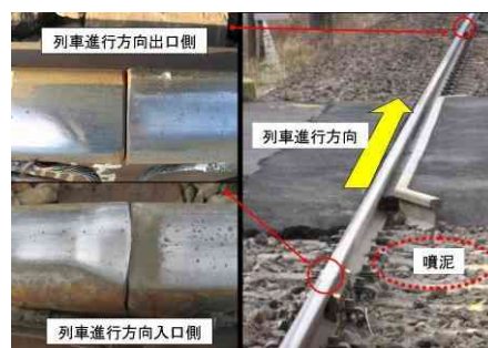
写真 1 レール頭頂面の状態
