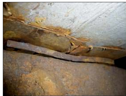
図-3 防食テープの変色
