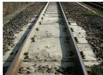
図-5 山手電車下り線 16k740m 付近
