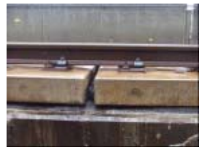
図 2 スラブ下面の CA の欠損
