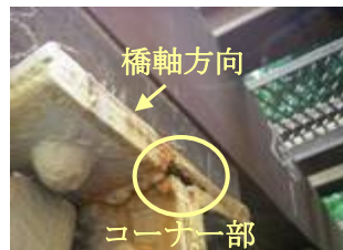
写真-2 山形鋼のき裂
