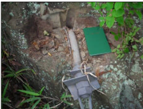
写真-2 崩壊後の落石防護網アンカー
