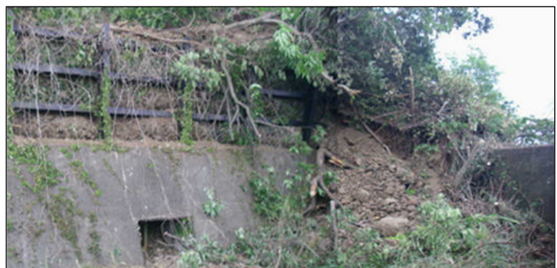
写真-3 崩壊後の落石止さく
