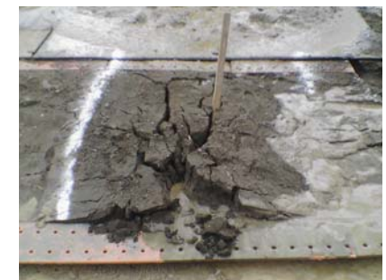
写真-4 地盤変状
