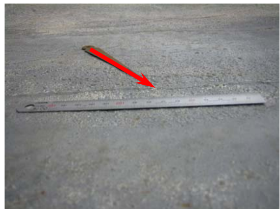
写真2 ひび割れ部の緩衝材変形（観察位置）
