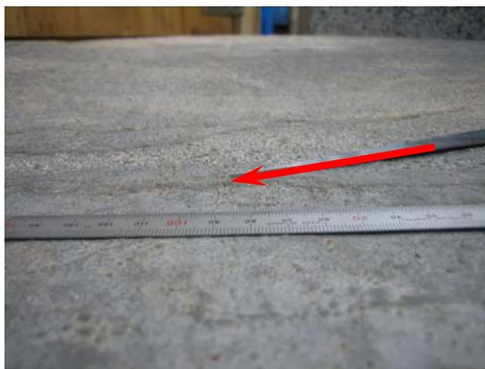
写真1 ひび割れ部の緩衝材変形（観察位置 - 2）
