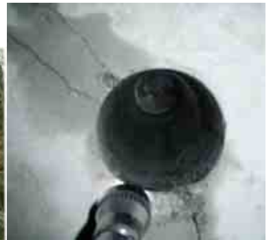
写真-2 南側坑口の東側サイドウォールに生じた斜めひび割れと調査コア抜き
