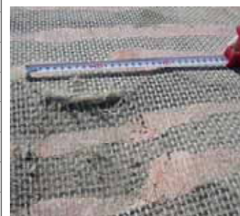
写真 5-2 繊維シートの破断状況
