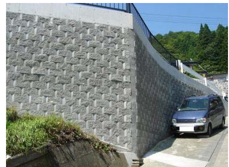
図 - 8 震度 5 強の地震を受けた現場 6) (2008 年 8 月撮影)
