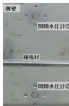
図-5 側壁の状況
