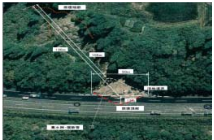
図 1 215.9KP の被災状況
