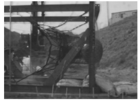
写真-2 対策あり
