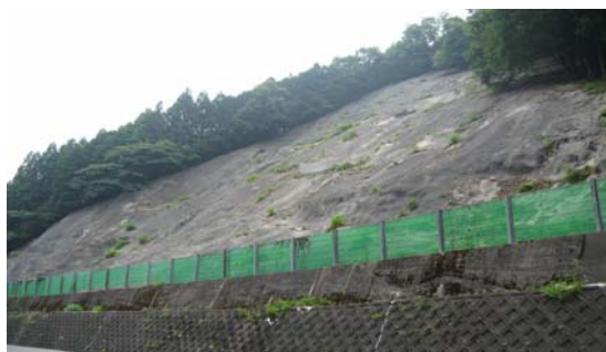
図-3 A 地区現場写真
