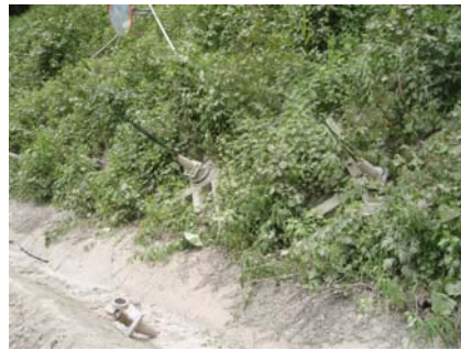
写真-3 引張材の飛び出し状況
