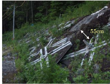
写真-1 すべり変位の発生状況
