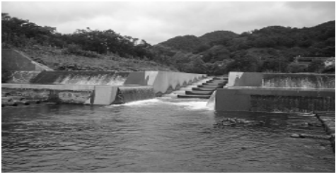
写真 1 引き込み型魚道の設置事例
