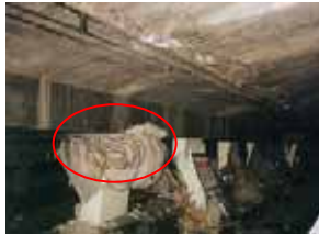
写真-1 駅舎部実被害写真
