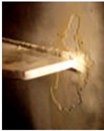
写真-1 2 連目亀裂
