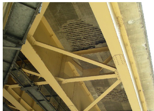
写真 1. 床版下面の劣化状況
